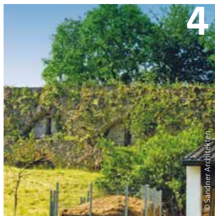
Starker, langjährig etablierter Bewuchs in sensiblen Mauerwerksbereichen.
