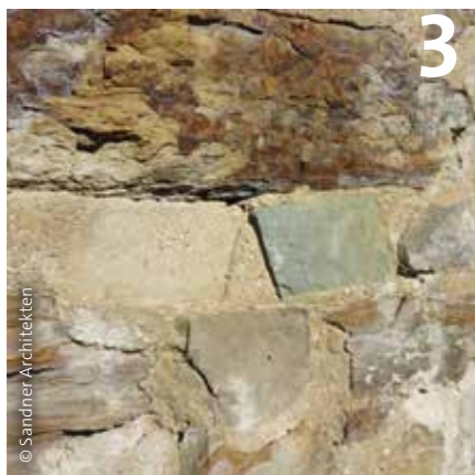
Mangelhaft ausgeführte Reparaturmaßnahmen mit flacher Verblendung von Schadstellen.
